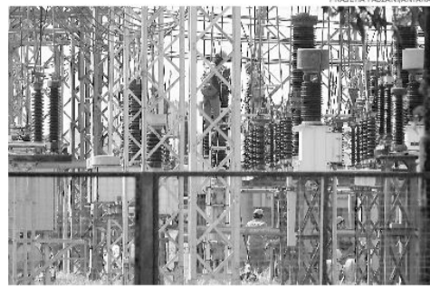
TARIF LISTRIK Pekerja beraktivitas di Gardu Induk Tegangan Ekstra Tinggi (Gilet) transmisi Jawa bagian timur dan Bali di Kota Kediri, Jawa Timur, Rabu (8/4). PT PLN [persero] memastikan tarif listrik rumah tangga nonsubsidi golongan 900 VA dan 1.300 VA ke atas tidak naik.
